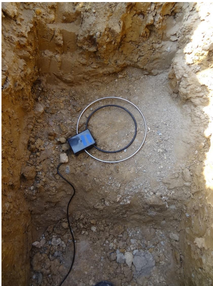
Obr. 4 – instalace čidel půdní vlhkosti na stanici PLZN
